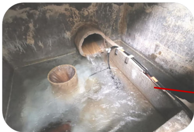
Captage de la Combe de l'Oche
